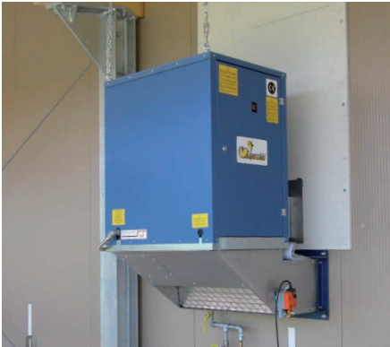
Chauffage au gaz
