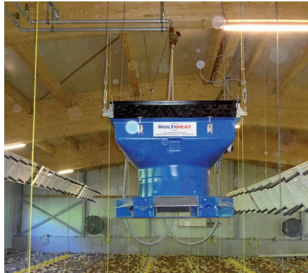
Chauffage à eau chaude
