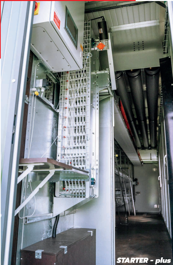
STARTER - plus : Sas d'hygiène avec une porte d'accès au local des socs
